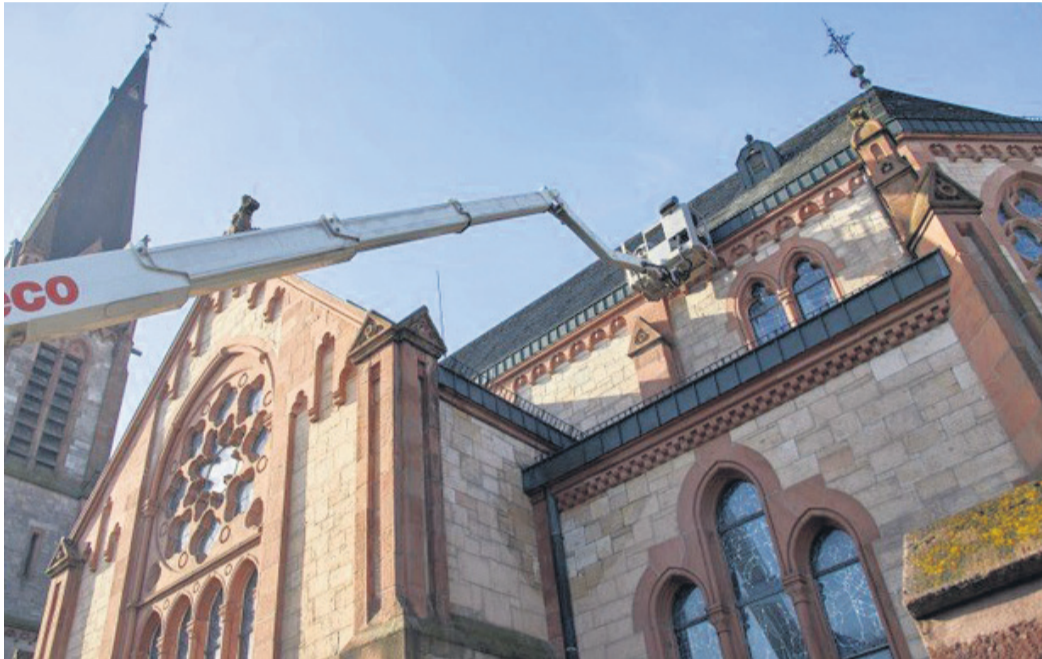
Der Rodgaudom muss dringend saniert werden.
