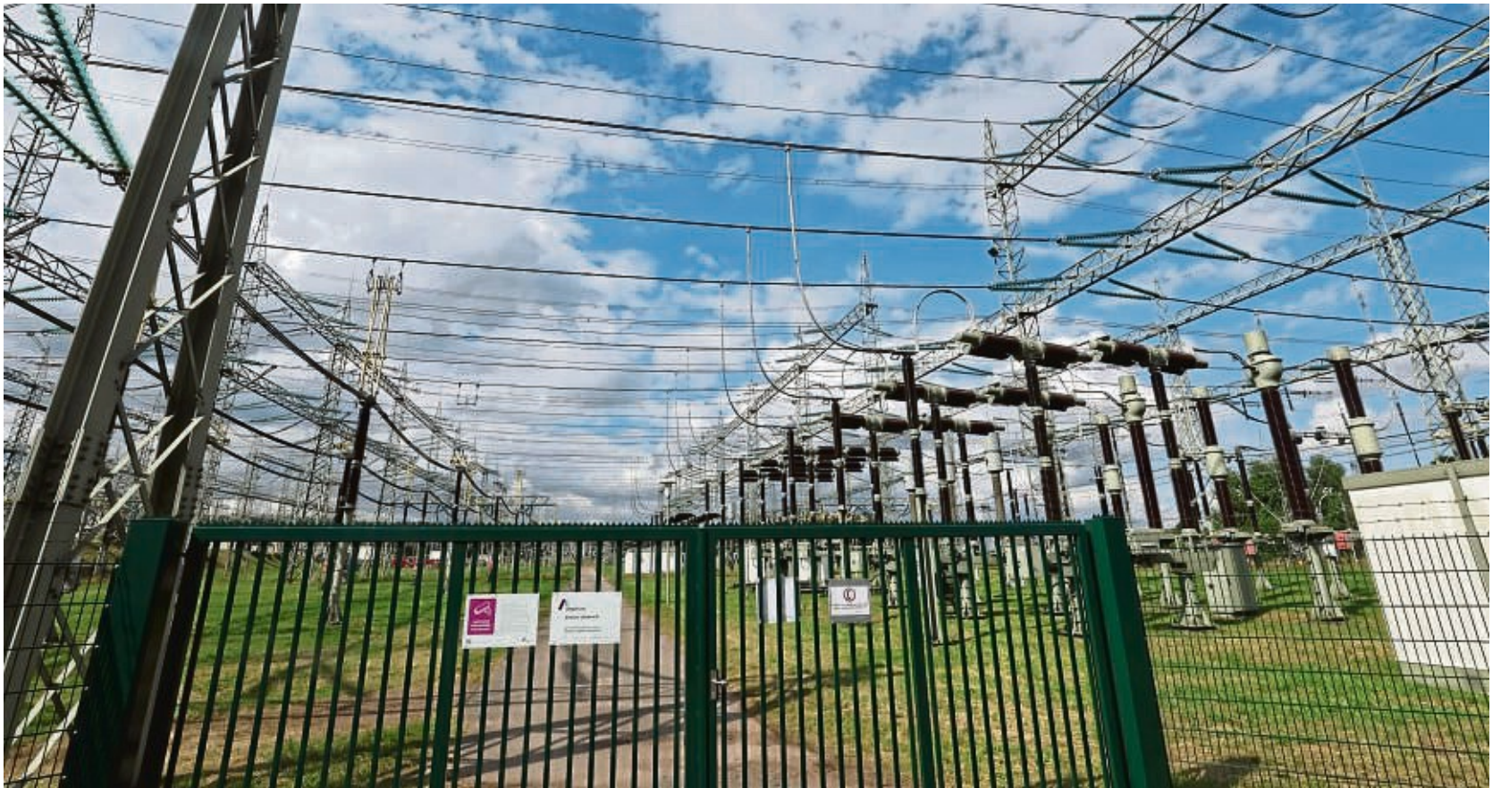
Das Umspannwerk des Übertragungsnetzbetreibers Amprion in Urberach kann auch Rechenzentren mit Energie versorgen. Der Magistrat soll nun prüfen, ob sich Urberach als Standort eines Rechenzentrums eignet.
