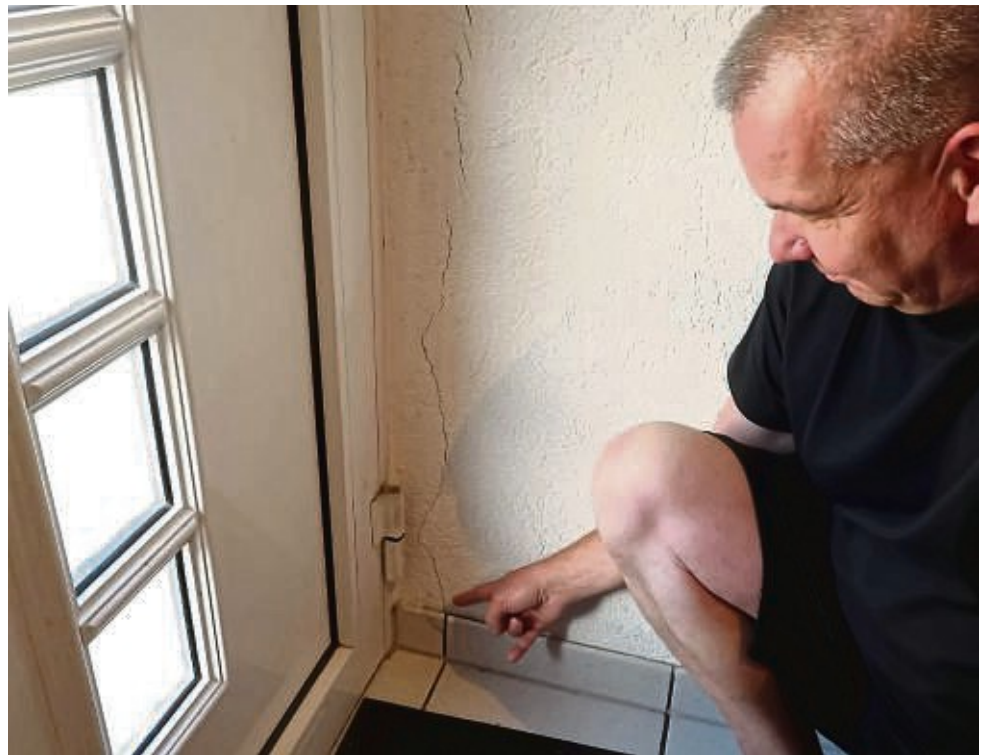
Risse an Wänden und Fliesen und den verzogenen Rahmen der Haustür führt Stephan Müller auf die städtischen Tiefbauarbeiten zurück. FOTO: WOLF
